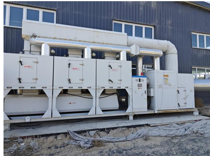
现有工程有机废气处理设施
