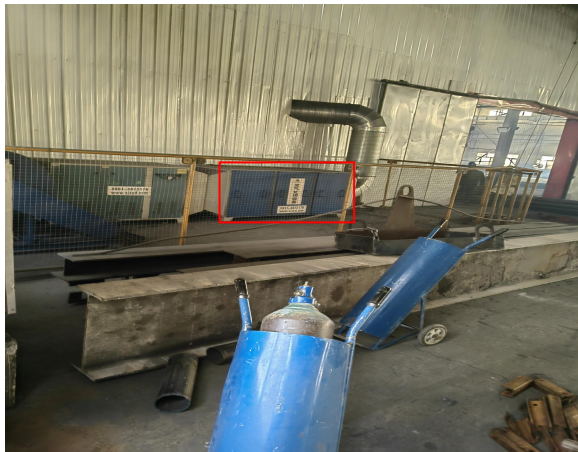
现有工程喷漆废气处理装置（活性炭+UV光氧）
